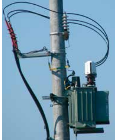
protection of simple transformer station 15/0,4kV Sicherung der vereinfachten Trafostation 15/0,4 kV
