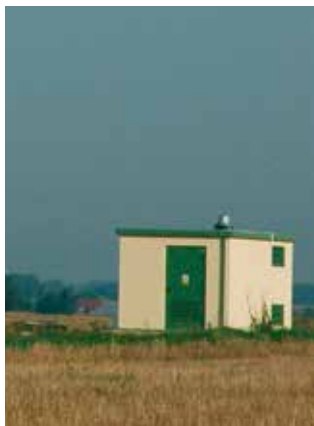
15/0,4 kV transformer station Trafostation 15/0,4 kV
