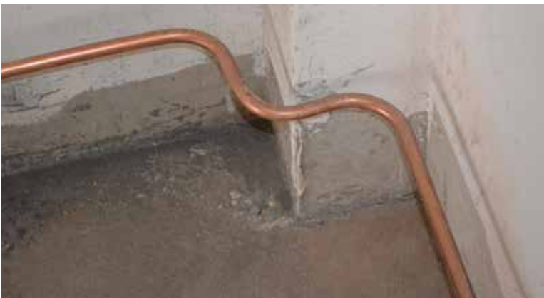
Equipotential grounding conductor
